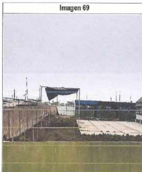
II.EE. n.º 80049 Desprendimiento de la lona.
