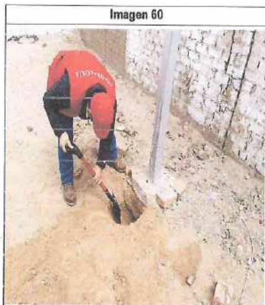
Imagen 60 II.EE. n.° 2306 No cumple con medida de 70cm de la base de concreto. Fecha: 6 de agosto de 2020 Lugar: Distrito La Esperanza, Provincia Trujillo.
